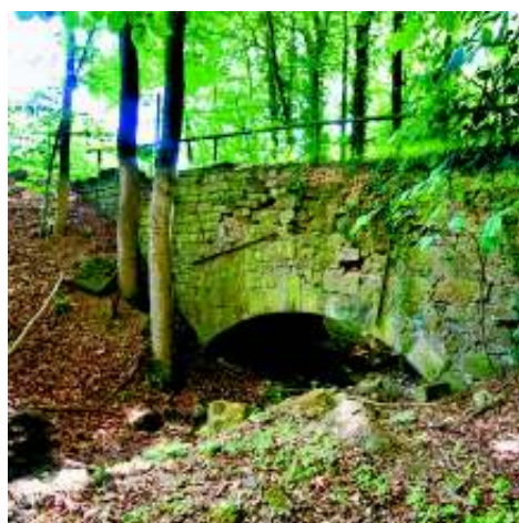
Die 500 Jahre alte Teufelsbrücke harrt noch immer ihrer Rettung. Foto: Horst Rudel
